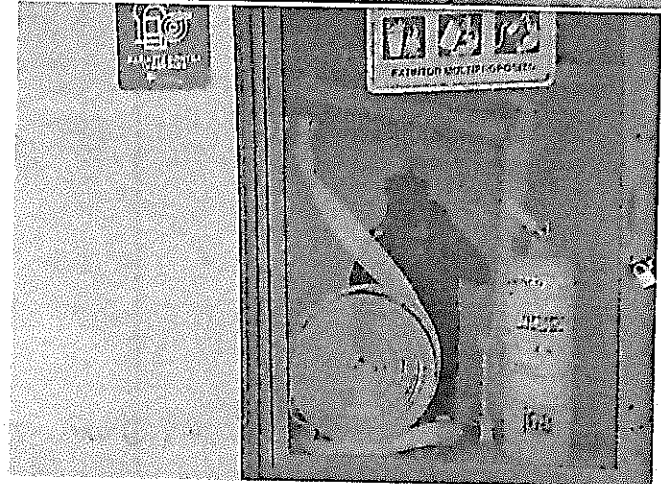
El edificio cuenta con 48 gabinetes contra incendio.
